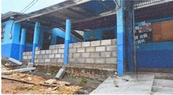
Foto 1: Sustitución de un metro malla por muro perimetral de la parte frontal del centro educativo.
