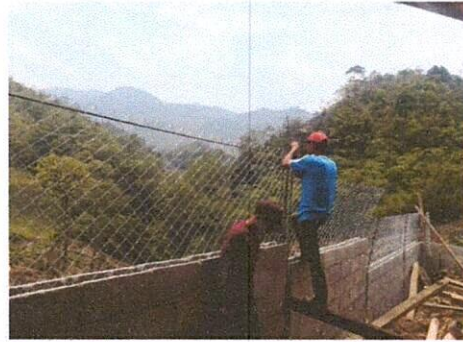
Foto 2: Sustitución de un metro malla por muro perimetral de la parte de atrás del centro educativo.
